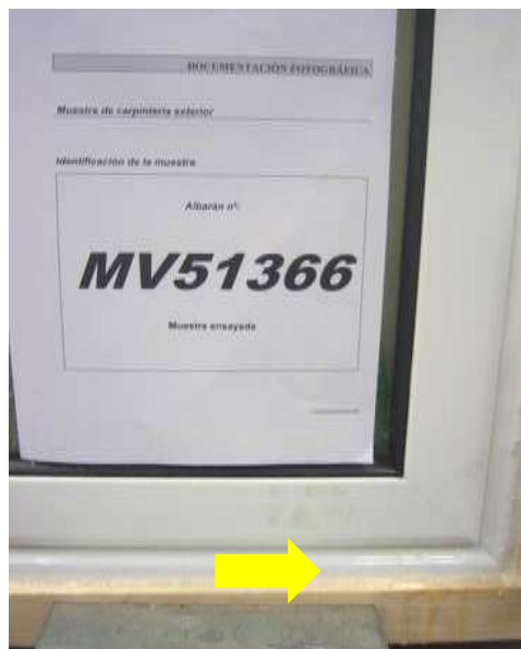
Zona de filtración de agua
