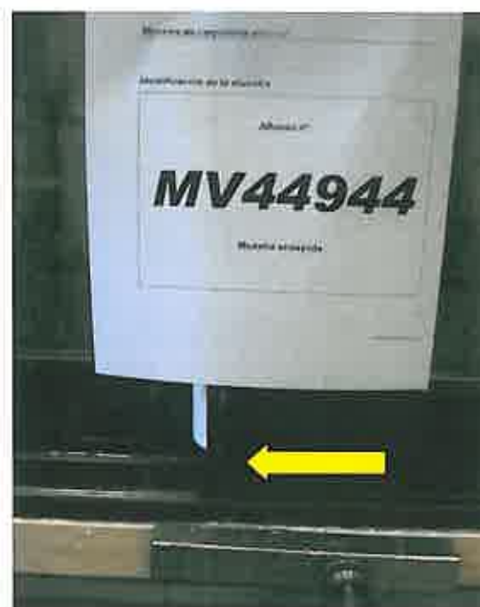
Zona filtración de agua
